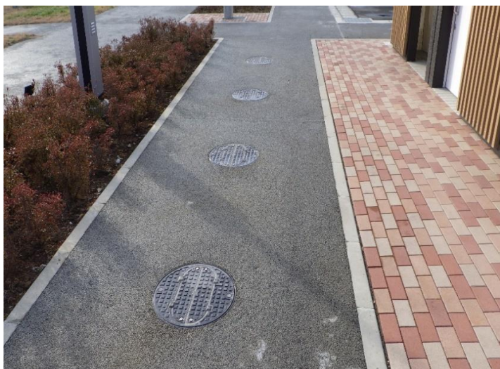
防災トイレ（通常時）
