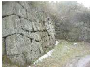
劣化が激しい小峰城の石垣
