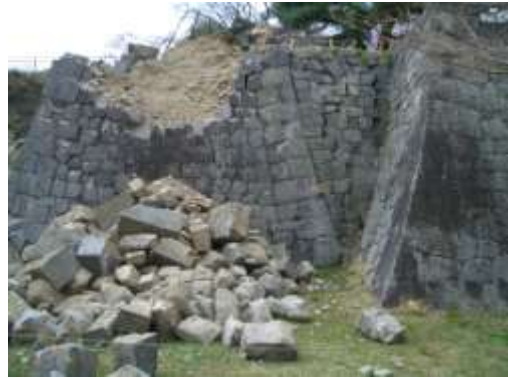
震災により崩落した石垣(月見櫓台)
