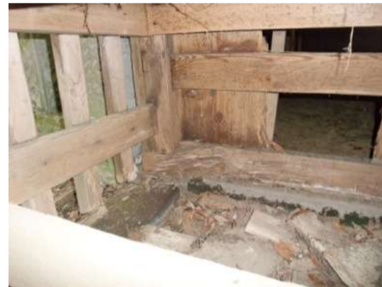
廟基礎部の損傷状況
