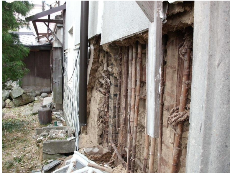
震災により被害を受けた歴史的建造物
