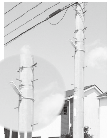
新たに設置したLED街灯
