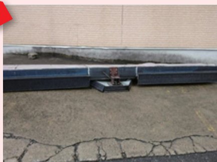
落下した欄間看板
