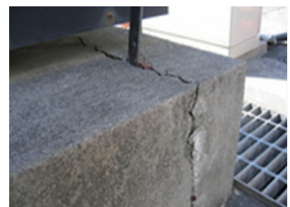
看板基礎のひび割れ
