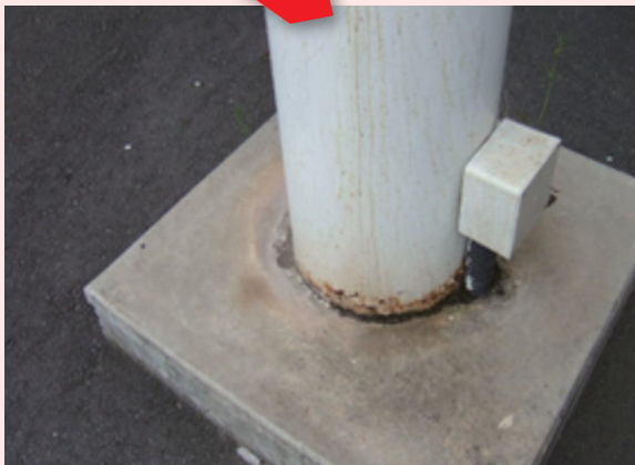
ポールの根元にサビが発生
