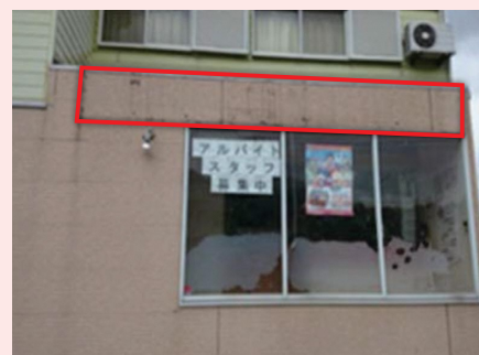
落下した後の壁面
