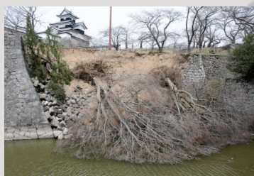
崩落した石垣上部の樹木
